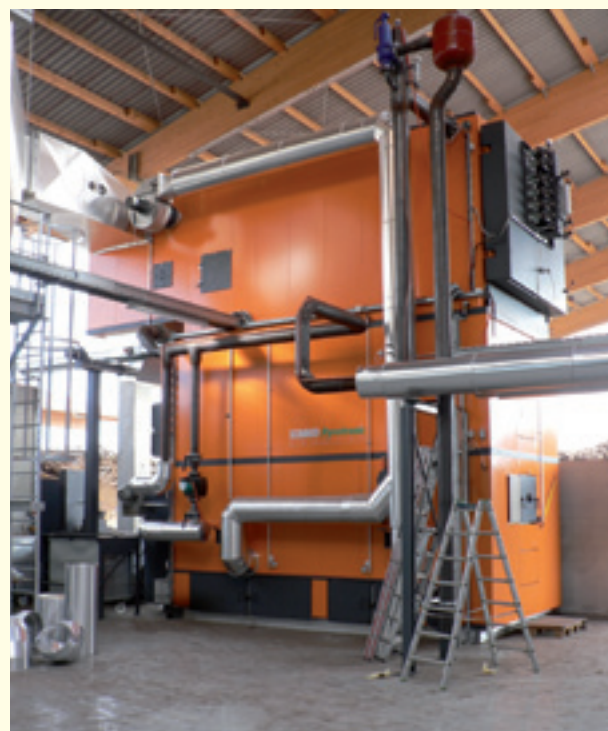
Holzhackschnitzel und Holzhackschnitzelheizung
